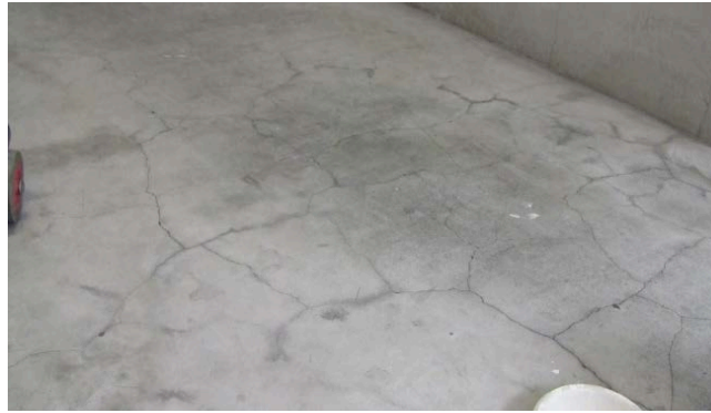
②施工前表面クラック
